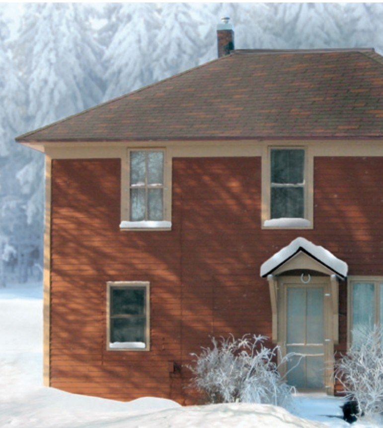
Schlecht gedämmtes Dach. Der Schnee schmilzt, da die Wärmeabgabe hoch ist.
